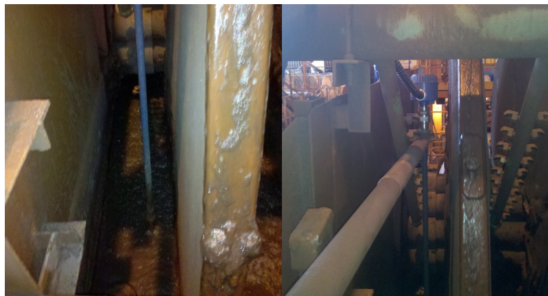
Figura 9 – Transmissor instalado no filtro
